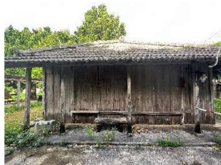
写真5-22 空き家になり老朽化が進む古民家
